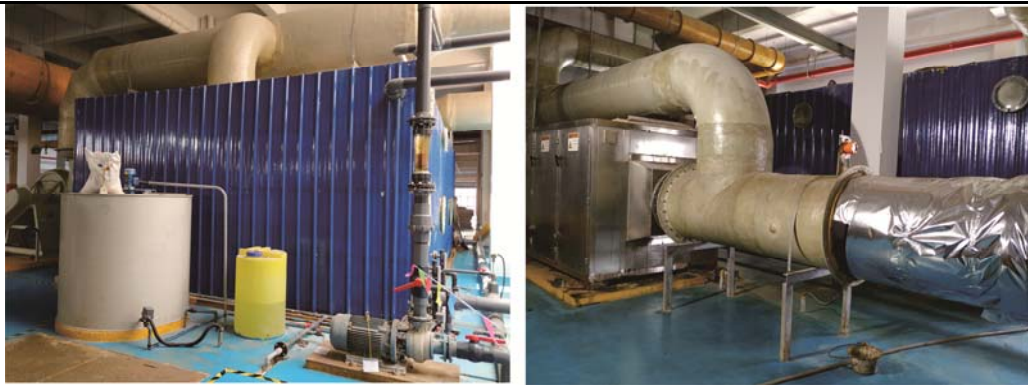
图 2-8 废气处理设施
